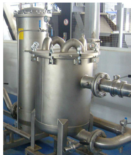
Filtre installé en ligne
