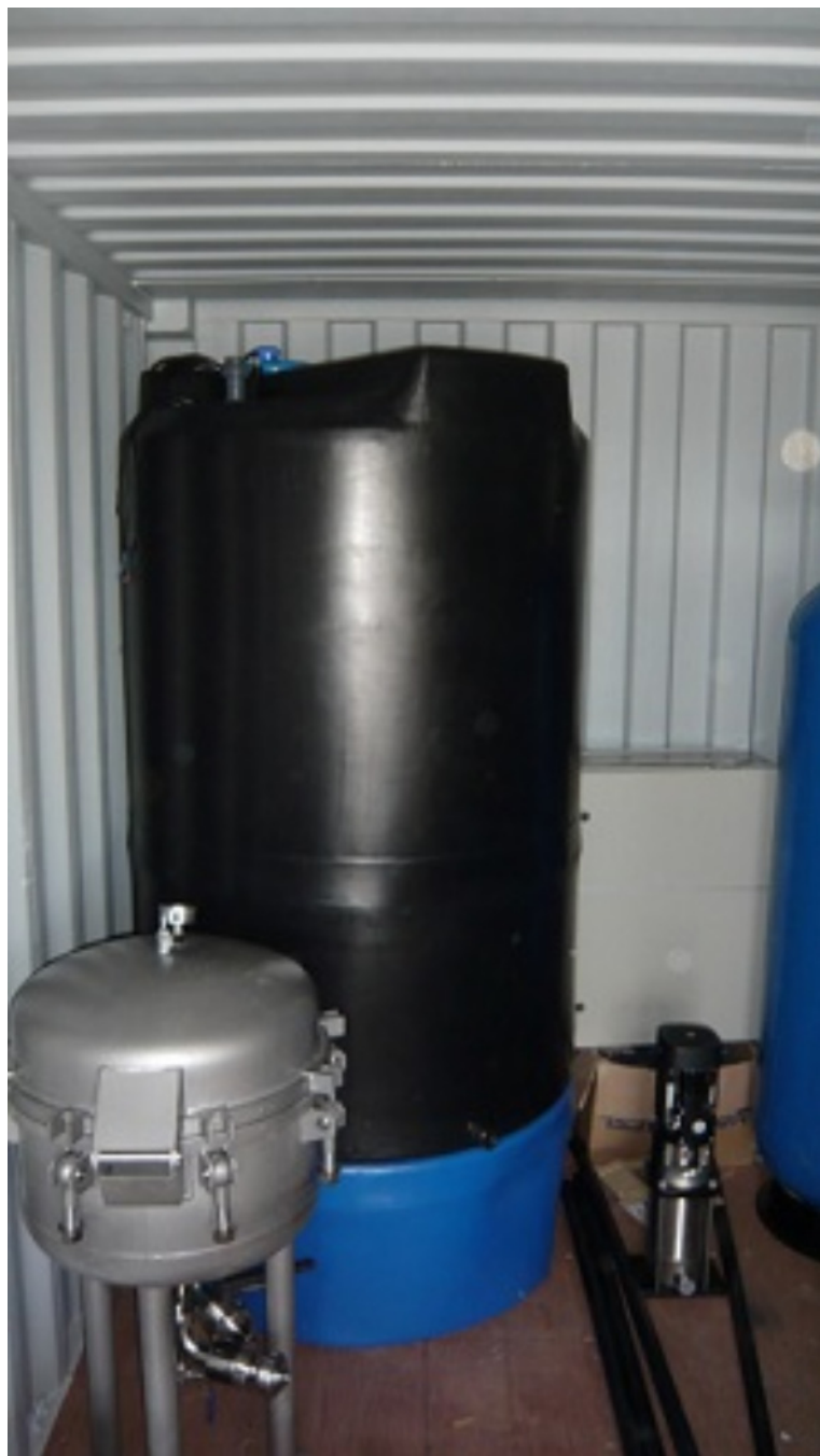
Cuves de stockage
